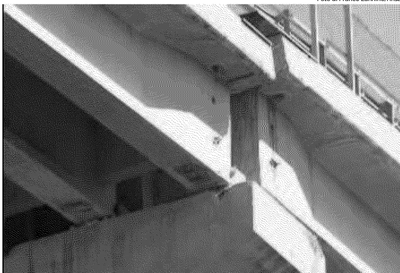
Il giunto che ha ceduto sul viadotto «Geremia 2» della Statale 646 Caltanissetta-Gela.
